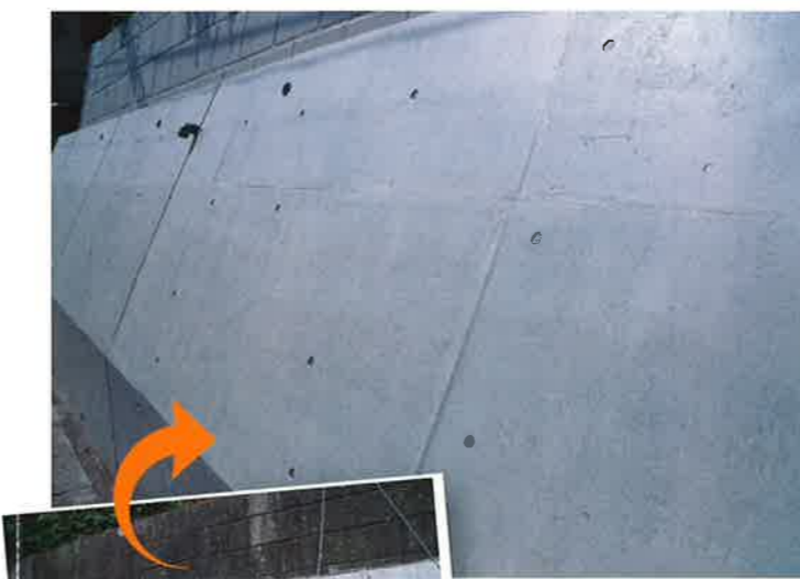
GCPコートによる下地補修跡の隠す (仙台市内・住宅壁)
